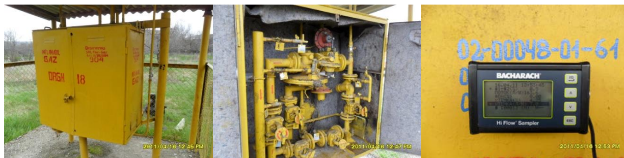
Figura 3 Post de reglare a gazelor
