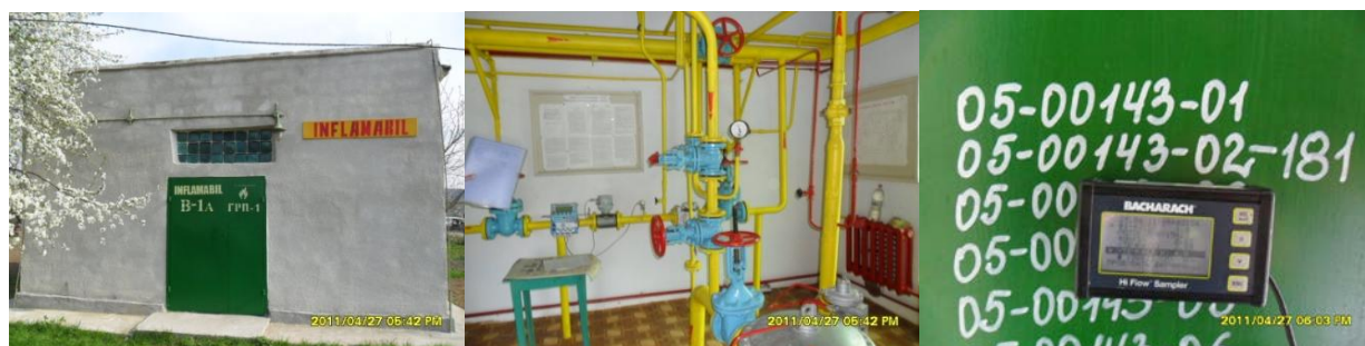
Figura 2 Stație de reglare de presiune înaltă
